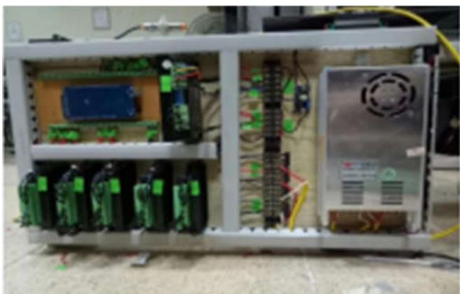
Hình 3. Hệ thống điều khiển
